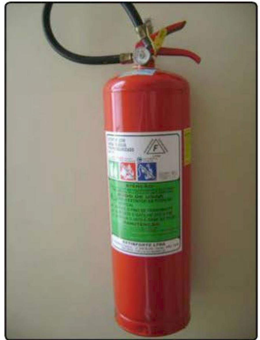
Figura 7. El matafuegos es la medida básica de seguridad, y el gas más utilizado en datacenters es el Halotron.
