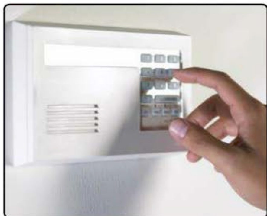
Figura 16. Los sistemas de alarma poseen un teclado numérico que permite activarlos y desactivarlos cuando es necesario.
