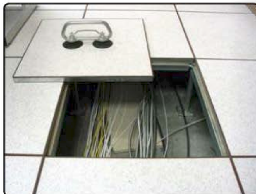
Figura 9. El piso técnico permite pasar cables de electricidad y datos por debajo de él.
