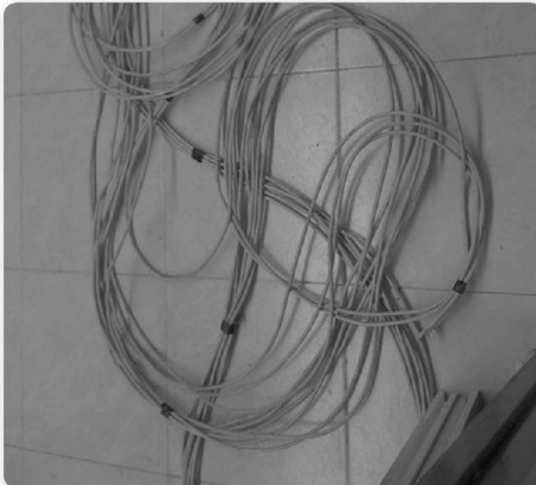
► Figura 11. Debemos cuidar que el cableado de red esté correctamente organizado, para así evitar accidentes y otros problemas relacionados.
