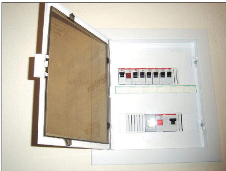
Figura 10. Las luces de un estudio de grabación se alimentan a partir de un tablero como éste, con llaves protectoras individuales que cortan la energía ante el mínimo exceso.
