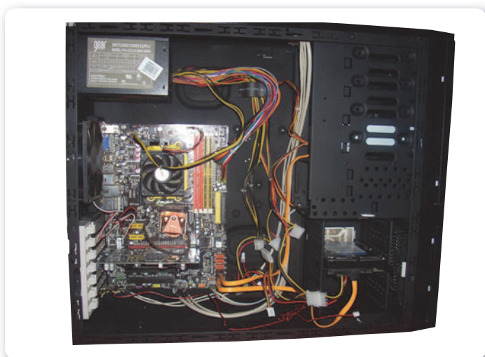
Figura 6. Los cables deben acomodarse usando precintos para que ocupen el mínimo espacio posible y, así, no interfieran en la refrigeración.
