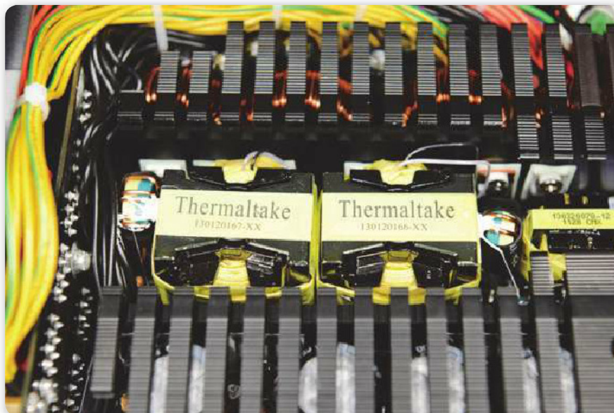
Figura 13. Los transformadores son los encargados de llevar la tensión de la red a los distintos voltajes necesarios.
