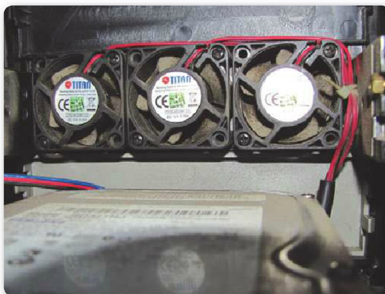
Figura 14. Mejorar la refrigeración del gabinete requiere colocar coolers especiales en él.
